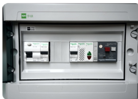
Skrzynka zabezpieczająco-alarmowa (z zabezpieczeniem przeciwporażeniowym w postaci wyłącznika różnicowoprądowego oraz wyłącznikiem silnikowym pompy). Dodatkowo wyposażona w alarm świetlny i dźwiękowy. Obudowa 6 modułowa o stopniu ochrony IP 65.
