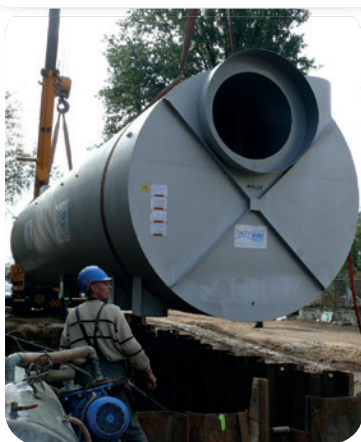
Kalisz - Instalacja Separatora Stalowego Y2EAA12A z regulatorem przepływu.
