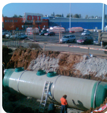
Separator Poliestrowy 135 l/s. Obwodnica Karlowe Wary - Czechy.
