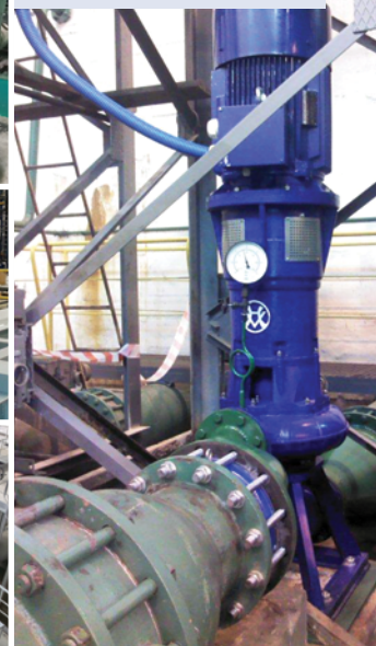
Elektrownia Jaworzno - Pompy FZ
