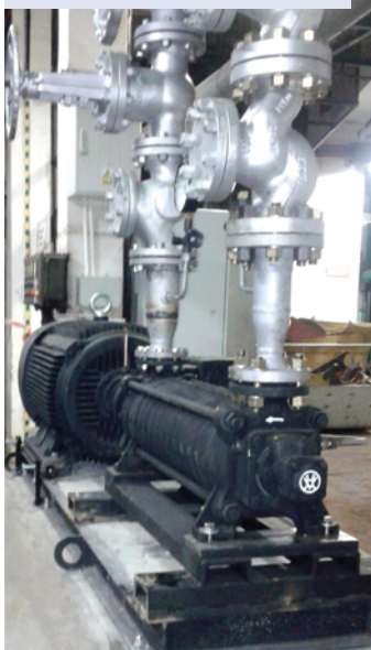
Elektrociepłownia Mielec - Pompa WH
