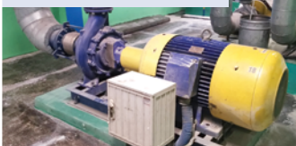
Elektrociepłownia Grodno Białoruś - Pompy WH
